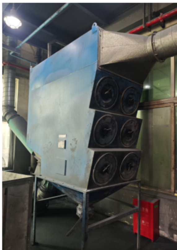
投配料粉尘布袋除尘
