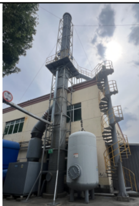
DA006 废气排放口
