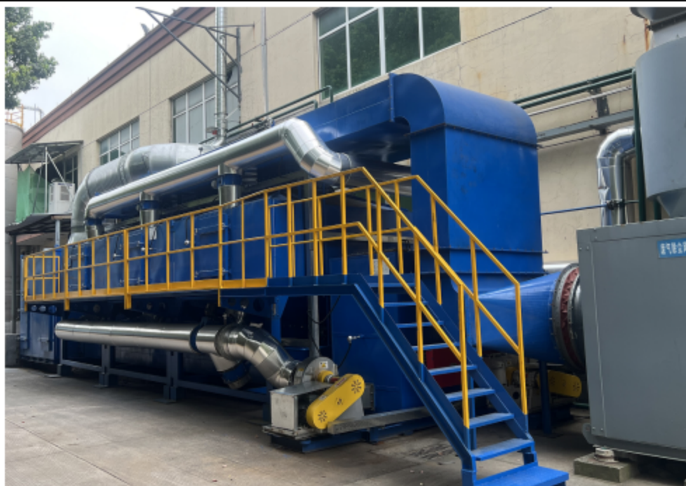
布袋除尘(密炼粉尘预处理)+初效过滤+活性炭吸附脱附催化燃烧
