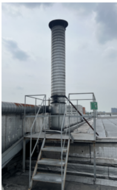
DA035 废气排放口
