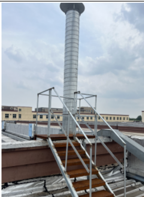
DA037 废气排放口
